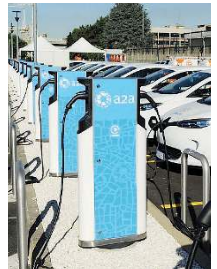
Centraline. Infrastruttura necessaria
